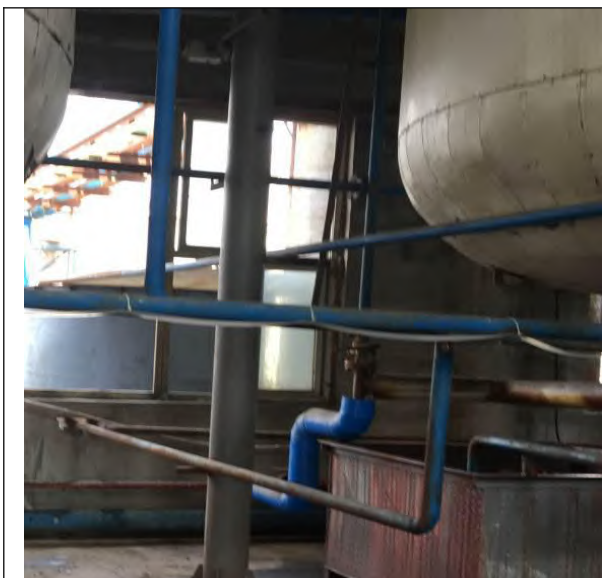
车间碱洗废水管网
