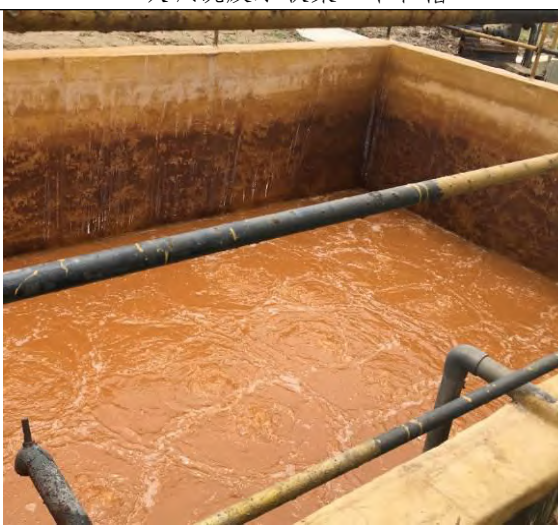
污水站废水调节池
