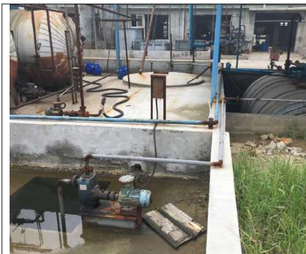
成品罐区围堰及收集池
