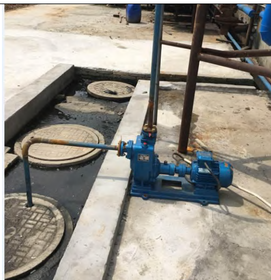
车间生活污水化粪池及进污水站管网
