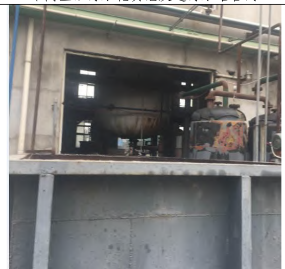
一次碱洗废水收集、中和槽
