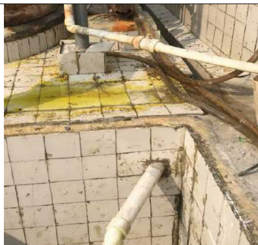
氯化氢废气吸收区防腐及收集池
