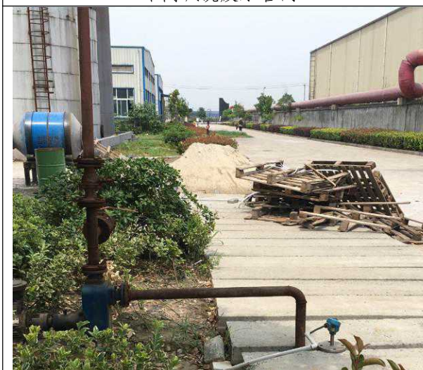
车间低浓度废水收集池及管网
