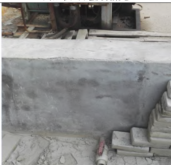
碱性废水收集区围堰及排放切换阀门
