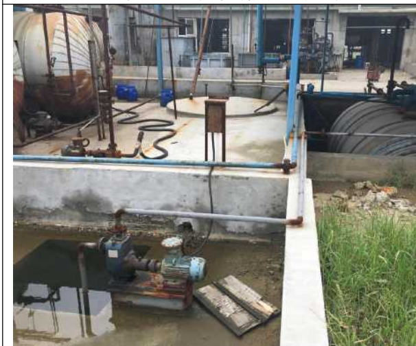
成品罐区围堰及收集池
